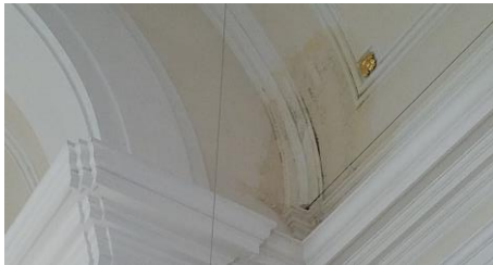
Wasserschaden an der Decke von St. Dionysius
